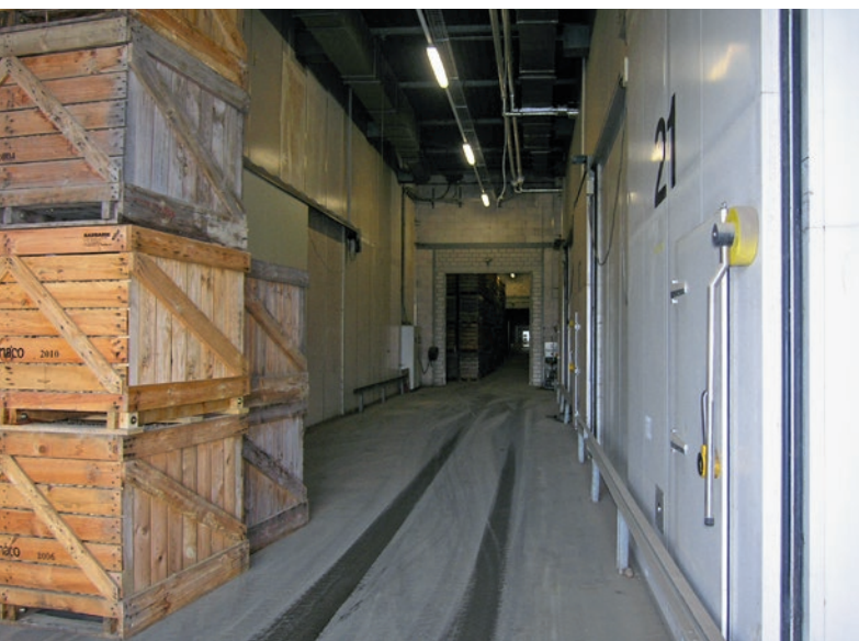
Abb. 1 | Kühlräume für die Lagerung der Kartoffeln.
