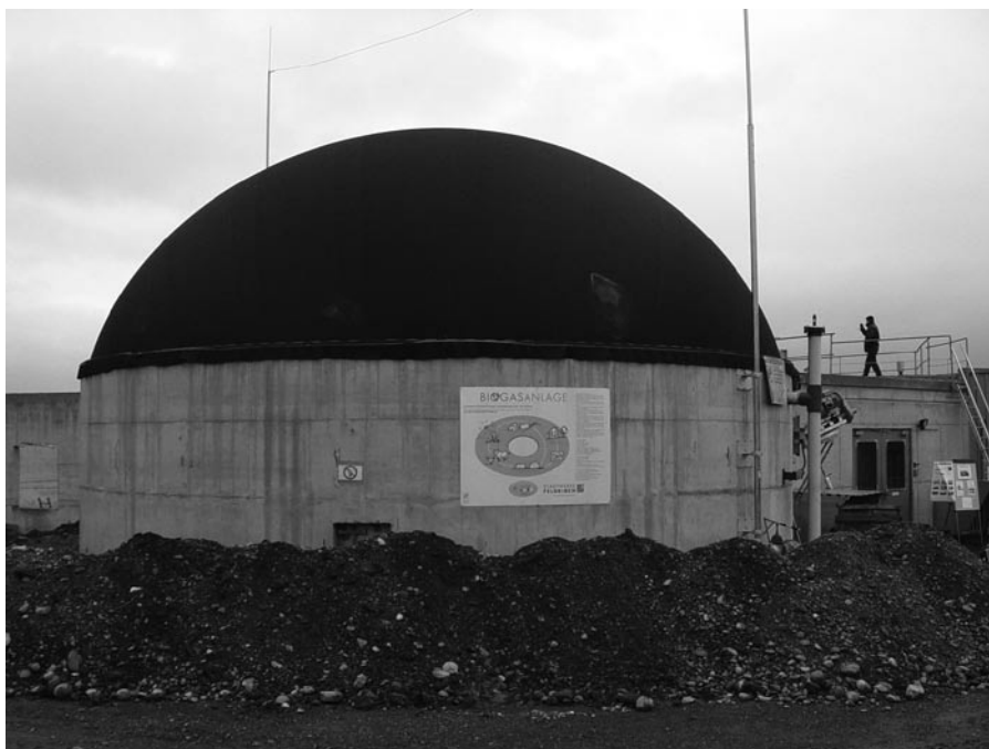
In Partnerschaft mit Feldkirch (A) erbaute Anlage. Zurzeit wird sie vergrößert, da die Biogasproduktion aus Substraten unterschätzt wurde. Die biegsame Membrane in Glockenform über dem Betonsilo speichert das Biogas.
