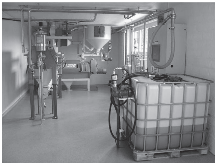
Abb. 3. Die Kernelemente der Ölmühle im 1. Obergeschoss: Seiher-Schneckenpresse und Speisung mit Lufterwärmer (hinten), Kammerfilterpresse (links), Feinfiltration und Steuerschrank (an der rechten Wand). Der fertige Rapsölkraftstoff fliesst hinten rechts oben über deckengeführte Edelstahlleitungen in einen 24'000 Liter-Erdtank, oder wird in IBC-Gittertanks abgefüllt (vorne rechts). (Foto: M. Meyer, SHL)
