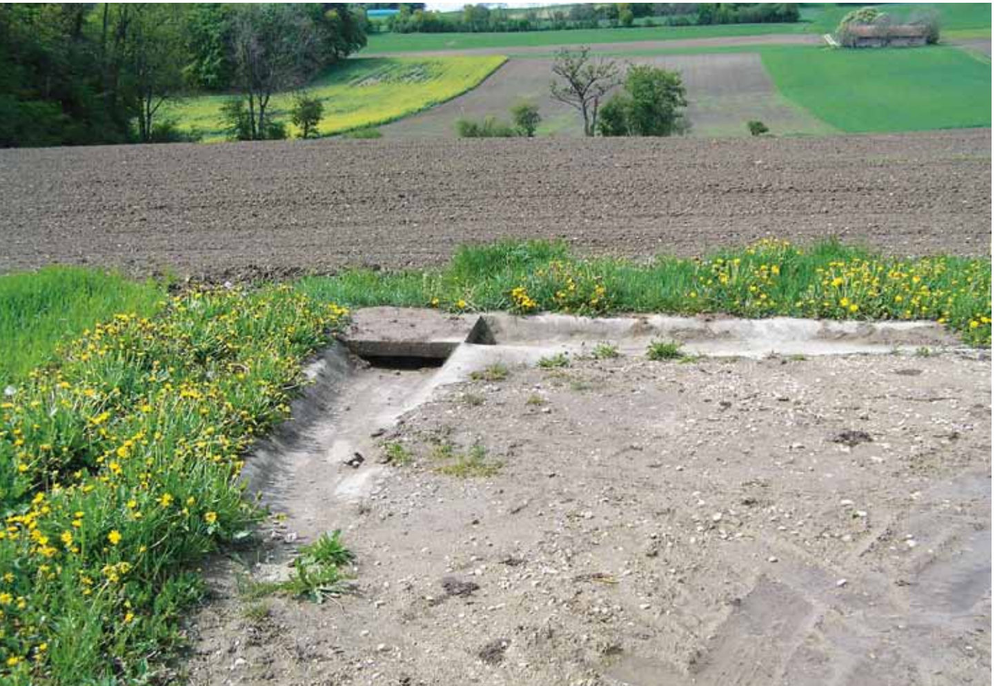
Kanalschacht mit Erdablagerungen, die teilweise aus Erosion der höher gelegenen Parzelle stammen.
