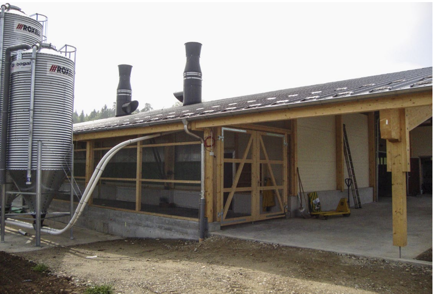
Abb. 1 | Doppelter Wärmetauscher in einem Geflügelstall. (Foto: ART)
