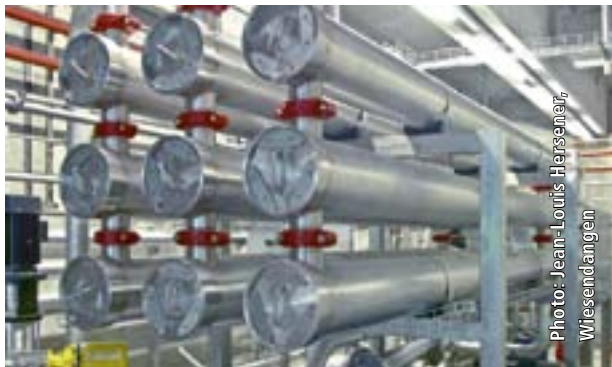
Figure 3 | Installation de traitement par osmose inverse.
