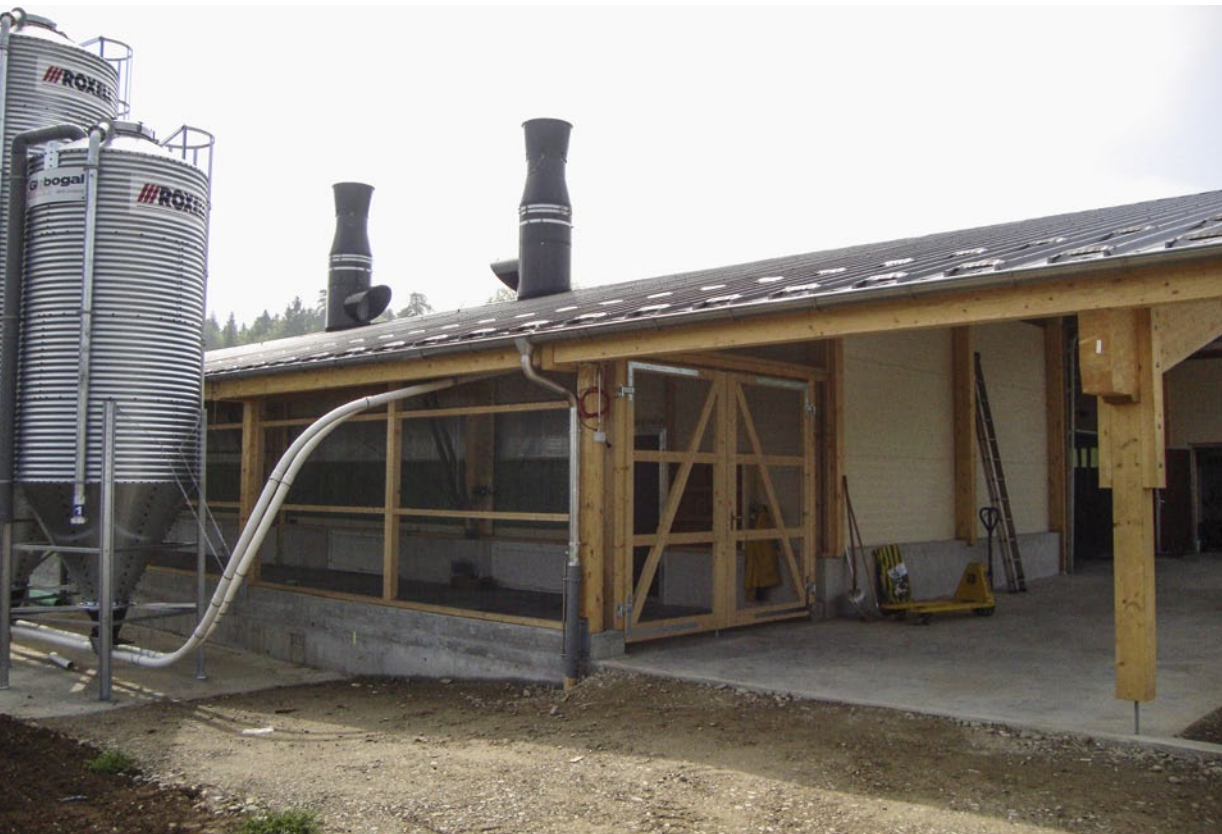
Figure 1 | Echangeur thermique double dans une halle d'engraissement de volaille. (Photo: ART)
