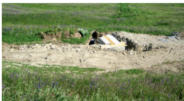
Figure 6 | Construction de nouvelles installations d'irrigation à proximité de précieuses prairies à sauge, à avoine jaunâtre et à fromental à Sent, en 2010. (Photo: Roman Graf)
