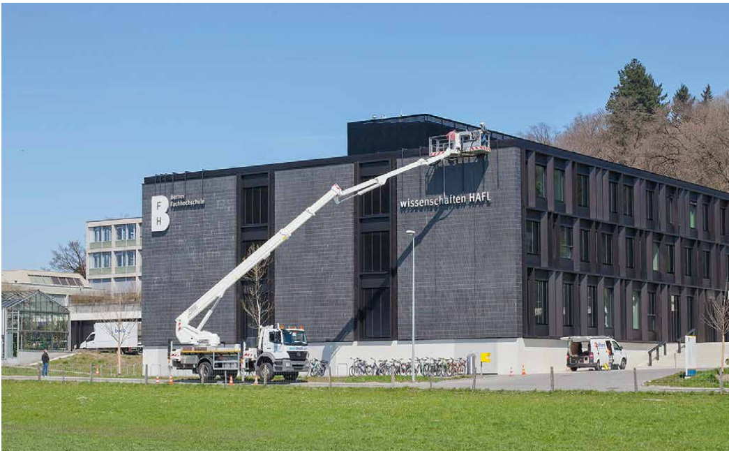
Concomitante à l'intégration complète dans la Haute école spécialisée bernoise: une extension des bâtiments.
